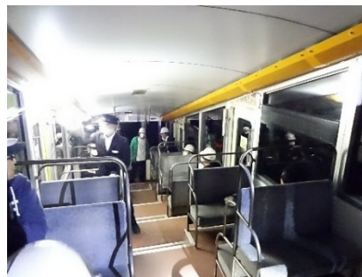
停電発生により非常灯を設置
