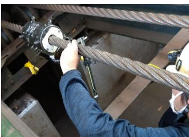
鋼索内部腐食調査
